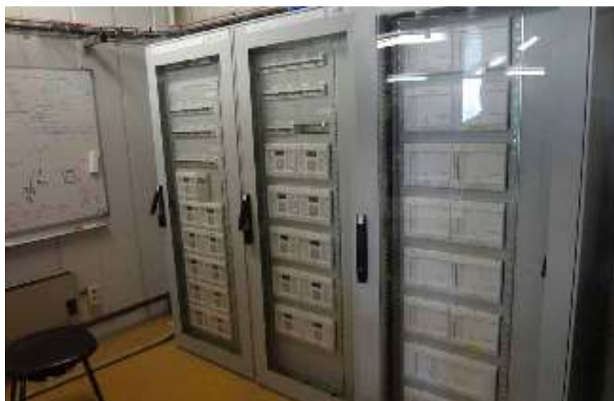
Рис. 3. Кластер интеллектуальных электронных устройств защиты и управления подстанции
