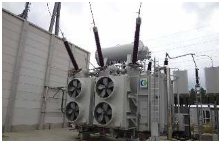
Рис. 1. Первичное оборудование подстанции
